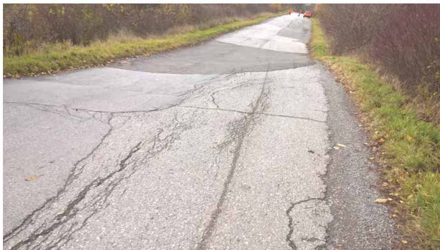
Obr. 4 Zosuv na ceste III. triedy III/3335 pri obci Varhaňovce
