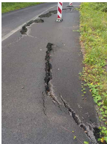
Obr. 1 Zosuv na ceste III. triedy III/3865 pri obci Čabiny
