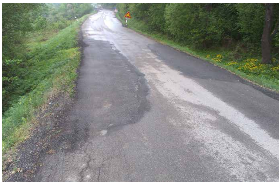
Obr. 2 Zosuv na ceste III. triedy III/3892 pri obci Kalná Roztoka
