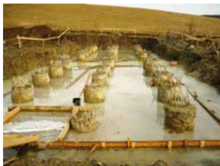
Obr. 6 Príklad zmeny hladiny podpovrchovej vody pri založení mosta SO 206-00 na úseku D1 Hričovské Podhradie – Lietavská Lúčka
